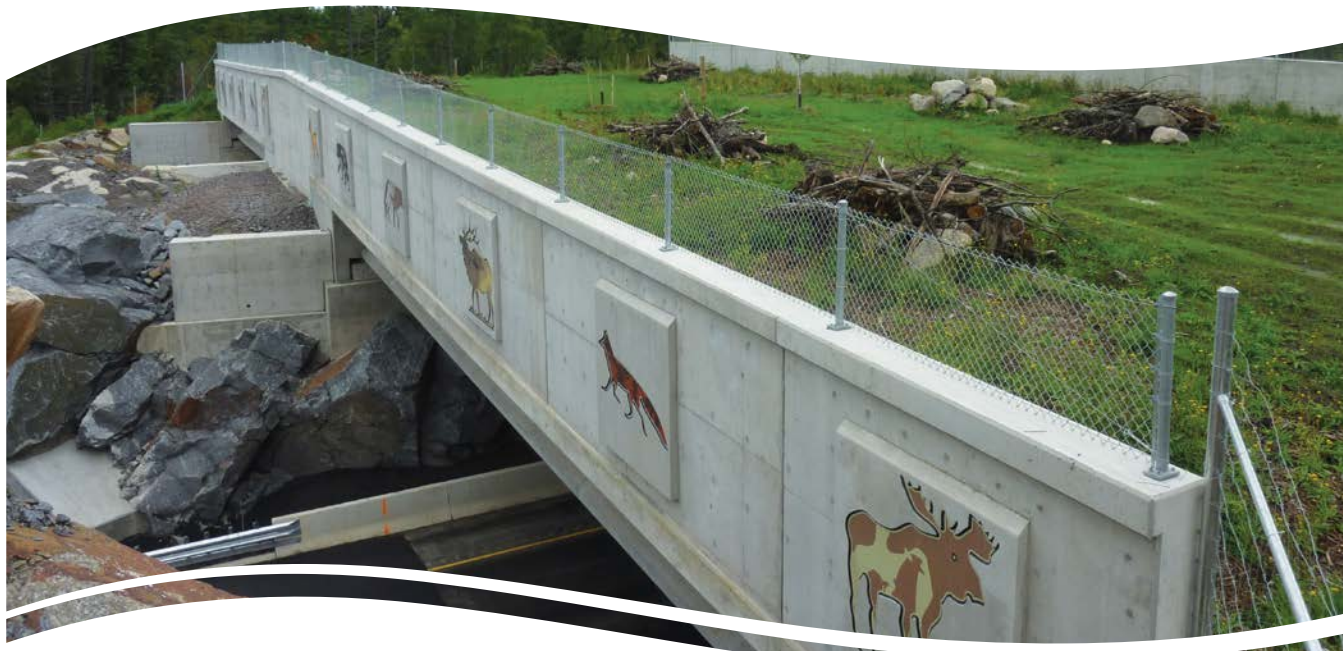
Passage faunique, autoroute 69 Photo : Mike Hall, MRN
